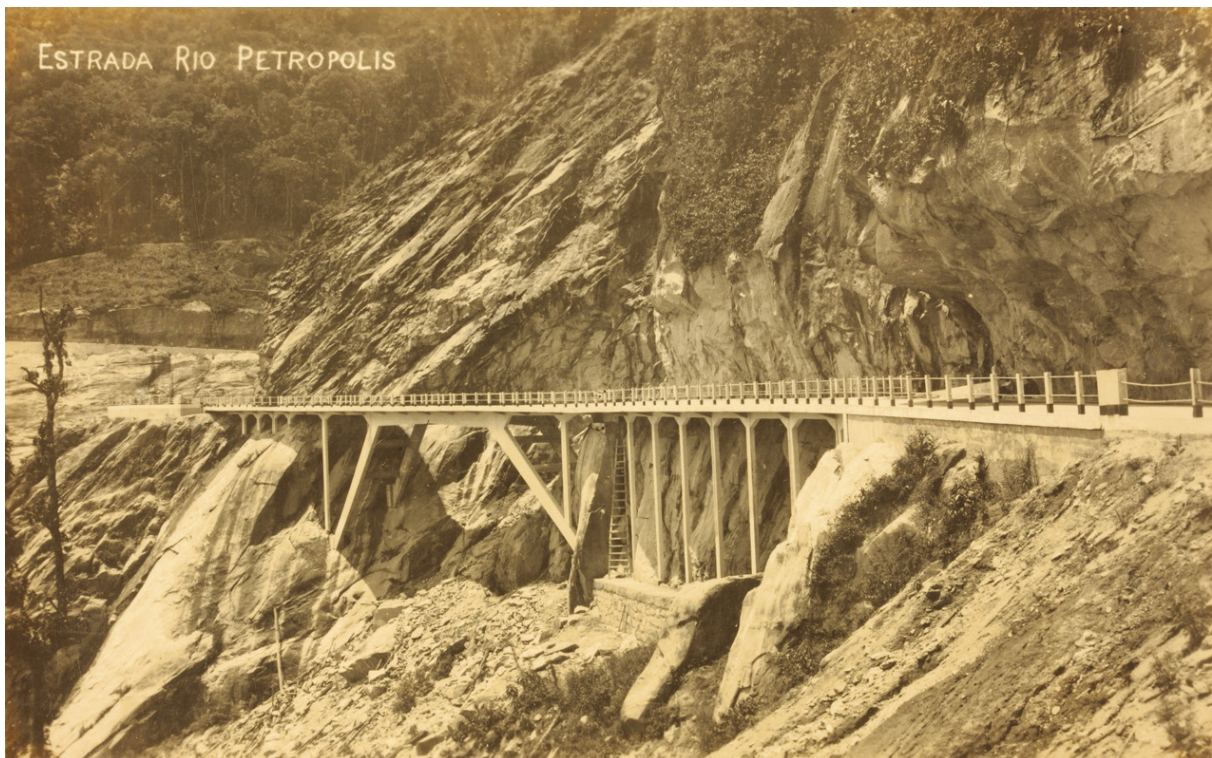
Figura 19: Terceiro viaduto da Estrada Rio – Petrópolis, inaugurado em 1928, na Serra de Petrópolis (RJ), em fotografia de autor anônimo (1931) – Nota-se a estrutura de concreto apoiada diretamente na rocha ou indiretamente, sobre pilares. Percebe-se, também, à direita, a encosta com afloramento rochoso em balanço acima do corte da estrada. Apesar da construção impressionante para a época, o trecho foi posteriormente substituído por um túnel, por questões de segurança. Fonte: Estrada... ([1931]).
