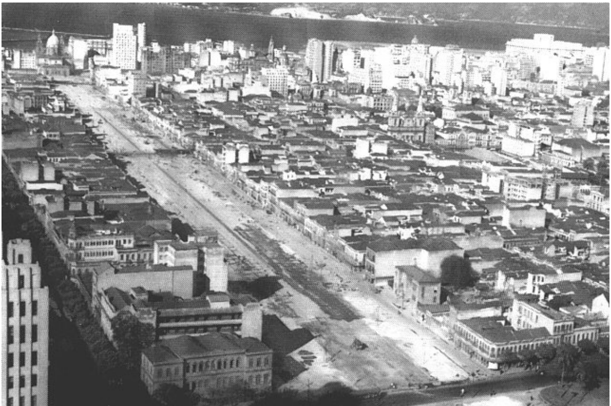
Figura 25: Obras de abertura da Avenida Presidente Vargas, no Rio de Janeiro (RJ) em 1944, em fotografia de autor anônimo – Ao fundo, vemos a Igreja de Nossa Senhora da Candelária e, no canto esquerdo inferior, parte da fachada lateral do Palácio Duque de Caxias, que então sediava o Ministério da Guerra. Fonte: Alma Carioca ([200-?]).
